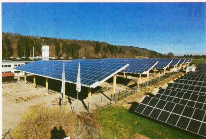
In Lautrach gibt es jetzt eine Fotovoltaik-Freiflächenanlage. Sie ist am rechten Bildrand zu sehen. Gleich daneben befinden sich die Dachanlagen der Firma FICO auf den neuen Lufttrocknungshallen und der Produktionshalle.
